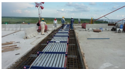
Installierte TENSAMODULAR Dehnfuge LR10 – mit einer Länge von 23.1 m
