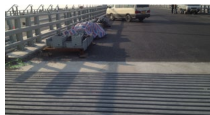
安装在椒江二桥上的伸缩缝
