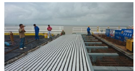
安装在桥面的伸缩缝
