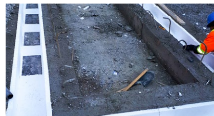
Eingebaute VIBRAX®BLOCK B Elastomerager
