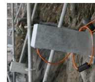
Monitorování skalních kotev
