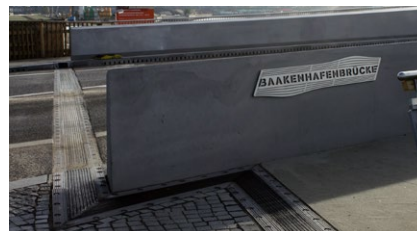
Vertikale und horizontale Knicke der Baakenhafenbrücke
