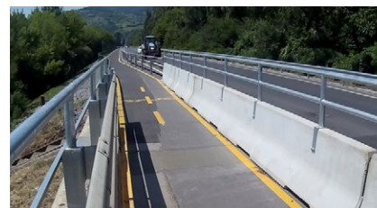
A híd déli hídfőjébe beépítésre került egyik TENSA®POLYFLEX ADVANCED PU dilatáció
