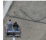
Monitoreo de grietas
