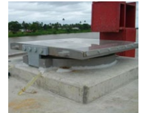
Apoyos de lanzamiento incremental (Apoyos ILM)
