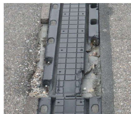
1 TENSA®CRETE Dehnfuge Typ RE 2 TENSA®CRETE Dehnfuge Typ RE-LS 3 Beschädigter bituminöser Fahrbahnübergang 4 Beschädigte Mattenfuge
